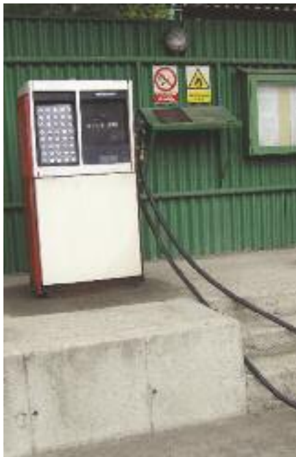
Čerpací stanice pohonných hmot vhodně zabezpečena proti únikům ropných látek i vlivu srážkových vod
